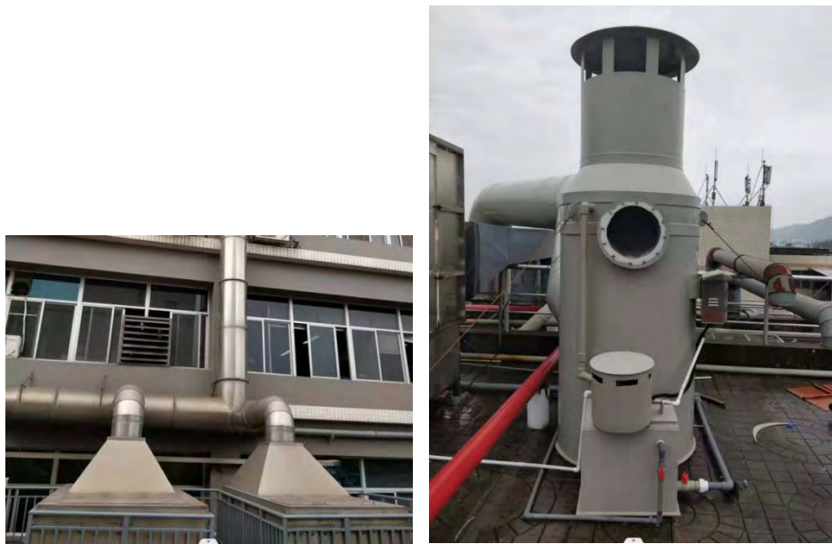
图 4.1-24 污水处理站臭气收集和处理设施现状照片
