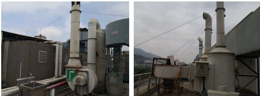
图 4.1-20 酸性废气塔现状照片
