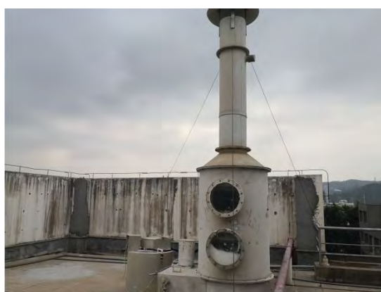
图 4.1-18 抛光粉尘处理设施现状照片
