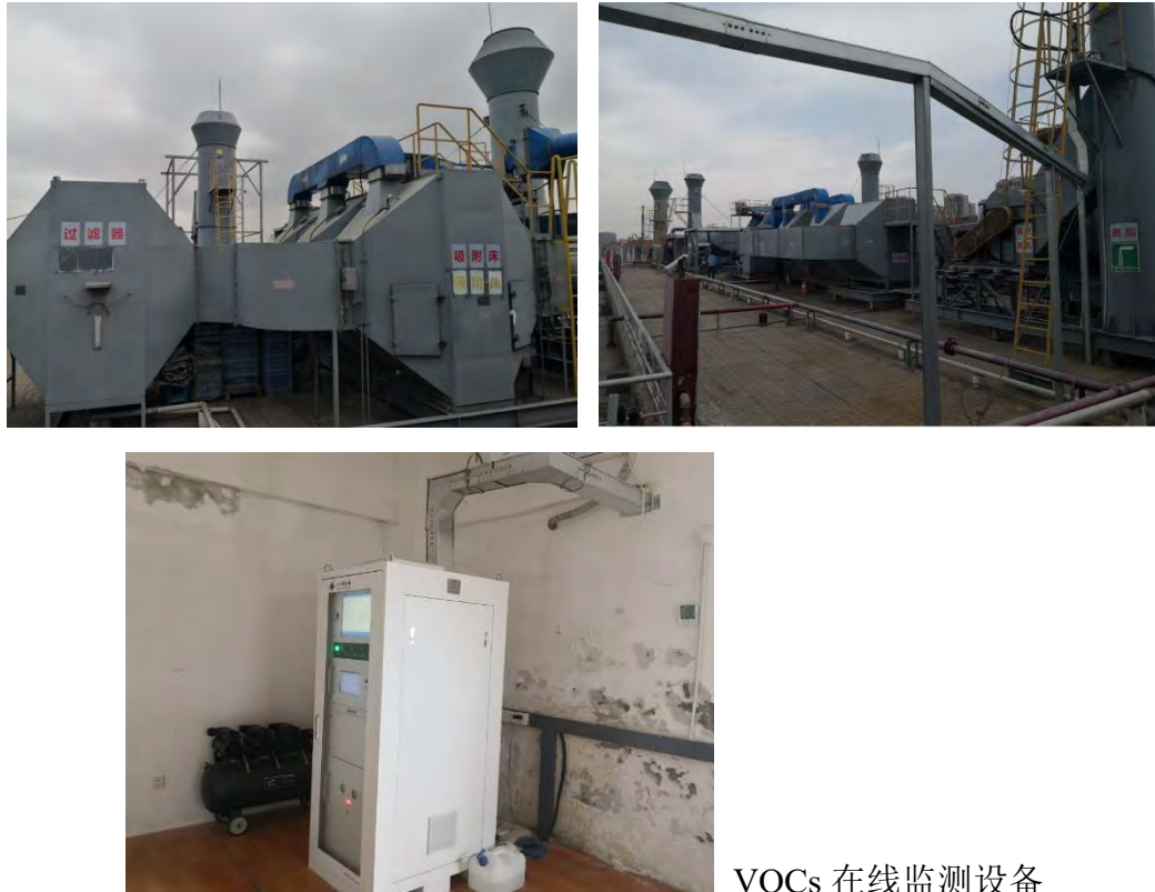
图 4.1-16 喷涂废气净化系统现状照片
