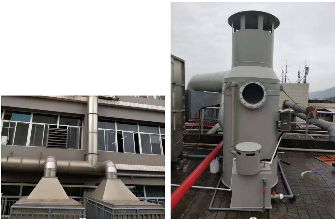
图 4.1-24 污水处理站臭气收集和设施现状照片
