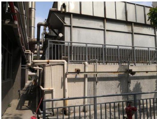
图 4.1-12 生化废水处理设施现状照片
