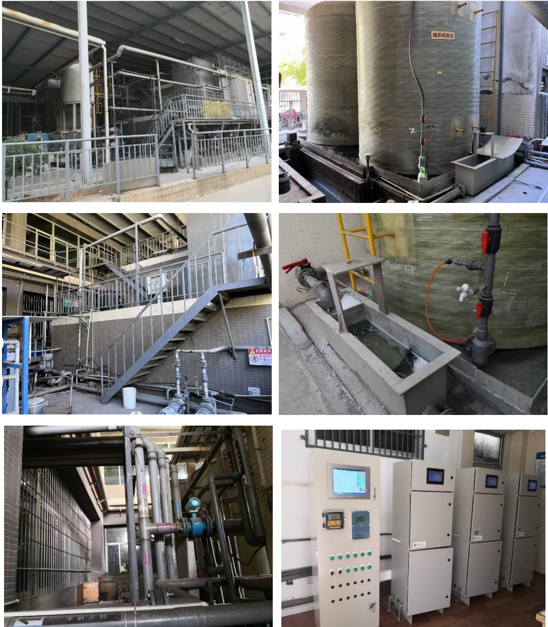
图 4.1-11 电镀废水处理设施现状照片
